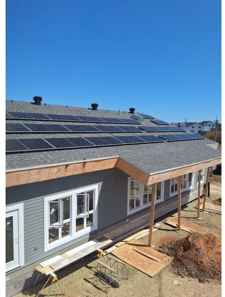
Bâtiment Le Phare , multilogement avec un seul compteur
