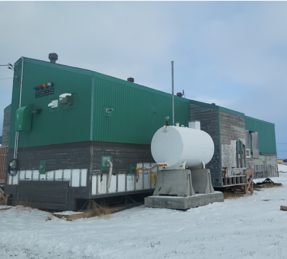
Témoins lumineux extérieurs sur un bâtiment à Akulivik, Nunavik
