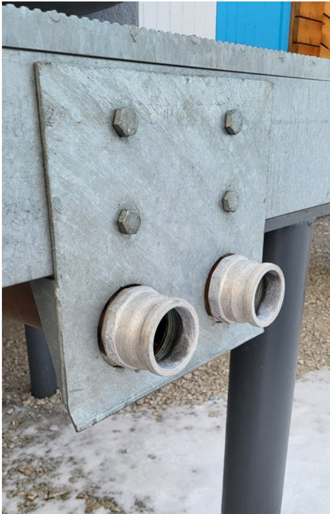
Raccords de soutirage d'eau usée à Sanirajak, Nunavut
