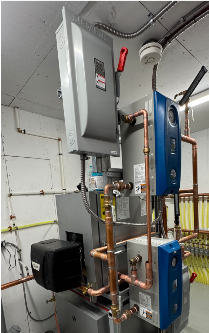
Installation de chauffage hydronique de type bi-énergie à Inukjuak, Nunavik
