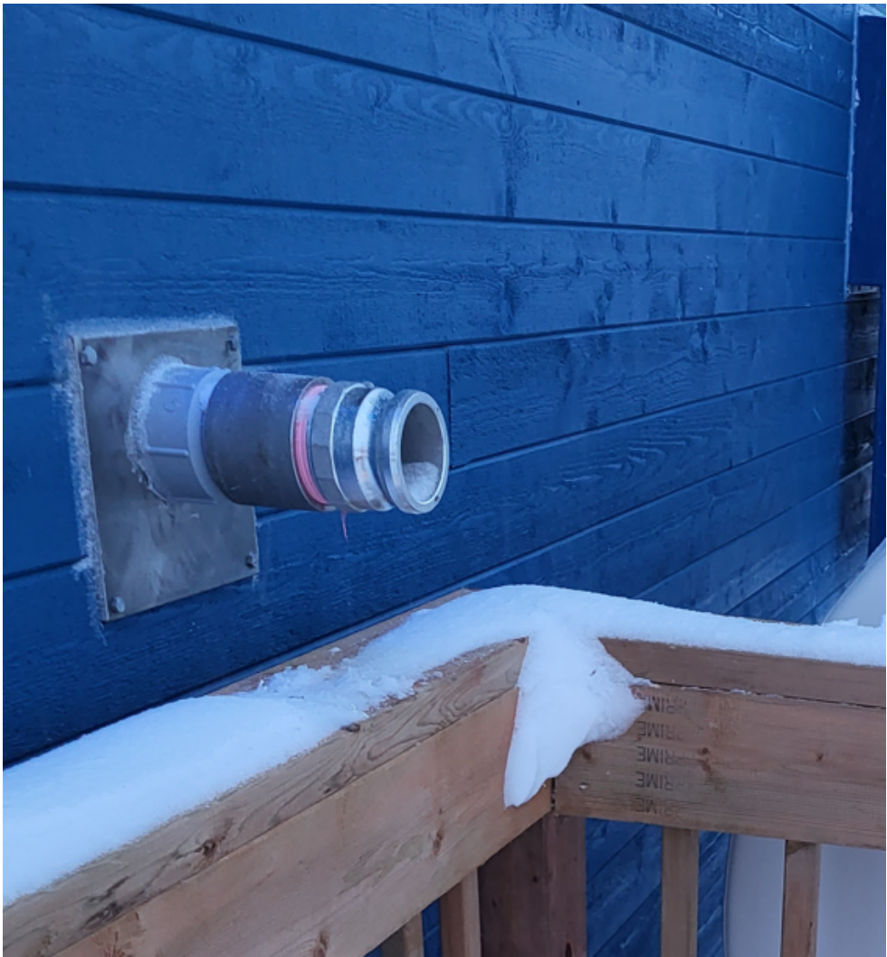
Raccords de remplissage d'eau potable à Quaqtaq, Nunavik
