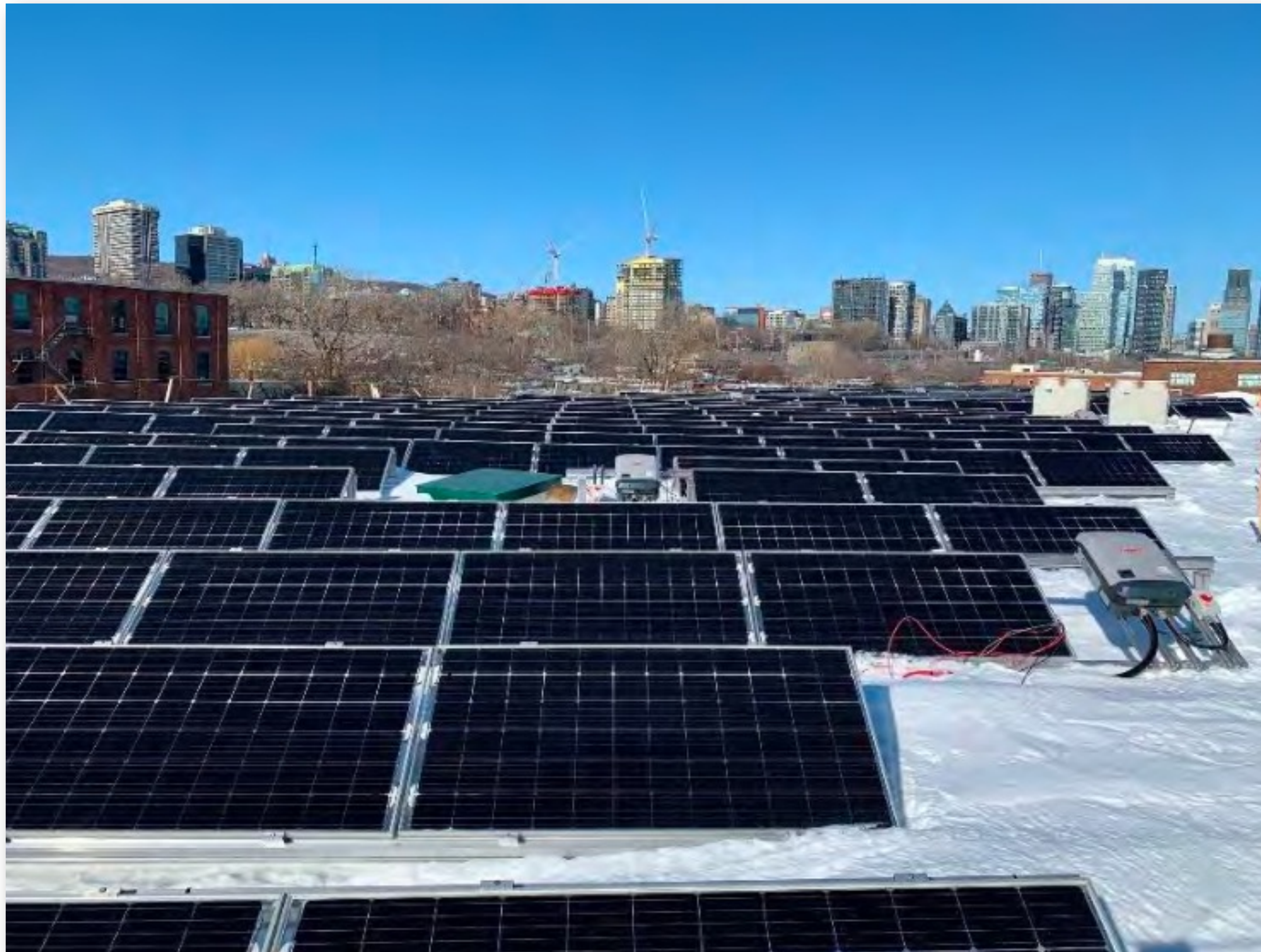
Panneaux photovoltaïques (Environ 400 panneaux)
