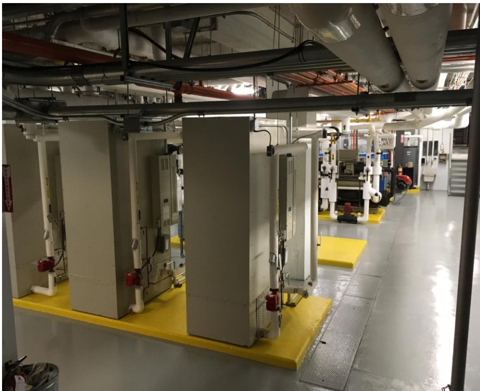
3 accumulateurs de 80 kw
