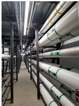
Corridor réseaux thermiques entre les deux usines
