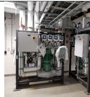
Distribution automatique chauffage / refroidissement procédé caillage, usine Bel
