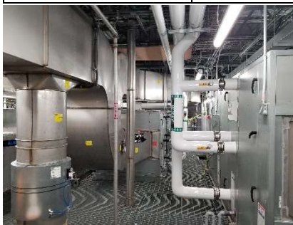
Alimentation chauffage/refroidissement unité air frais usine Bel
