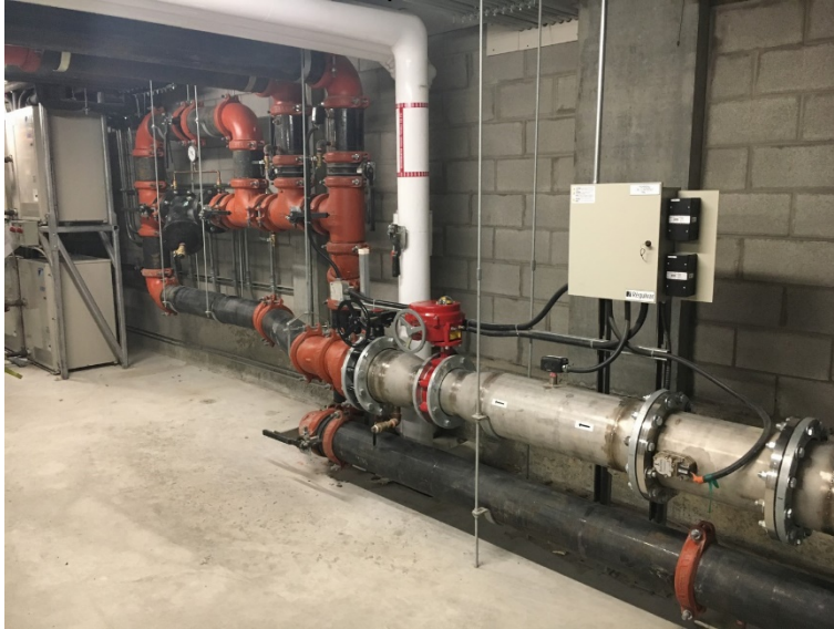
Salle de mécanique de l'immeuble
